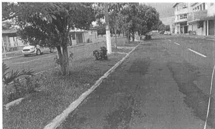
Figura 6 - Coordenadas Geográficas: 18°14'01.8"S 47°50'09.1"W - Avenida Cândido Ribeiro - Data: 10/01/2022
